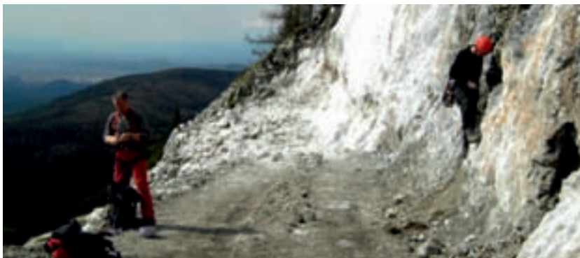
Abb. 5. Zerstörung des beliebten Felsensteiges über die Weiße Wand auf den Schöckl, Hausberg der Grazer, durch Errichtung eines genehmigten Forstweges
